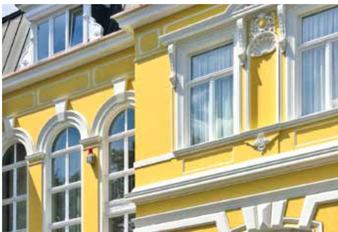
Die Originalfenster der Villa Erckens blieben im Rahmen der Sanierung erhalten. Das marode Holz wurde aufgearbeitet, Teilstücke ersetzt.
